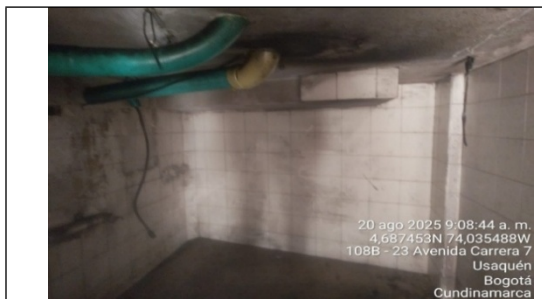
Foto No. 7. Antigua ubicación del compresor retirado
