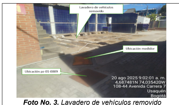
Foto No. 3. Lavadero de vehículos removido
