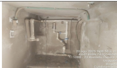
Foto No. 8. Sistema eléctrico de bombeo hacia tanques retirado
